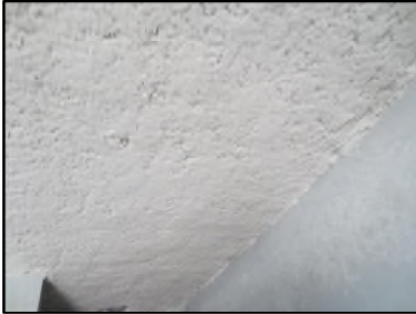
Photo N° 610 ECH-N°1 FLOCAGE -- HALL Plafonds BLANC COTONNEUX
